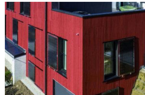
Abb. 126: PV-Schiebeelemente bei einem Plusenergiehaus (Vera Gloor Architektur)
